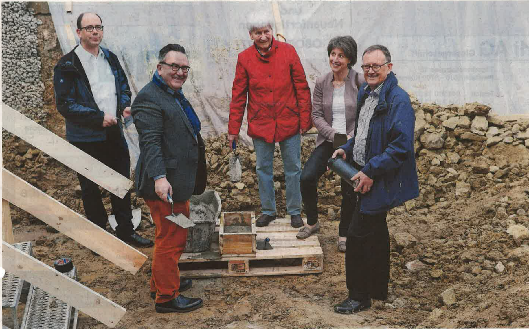
Beton und Dokumentenkapsel: Musikschulpräsident Luzius Appenzeller, Gemeindepräsident Christian Haltner, Loni Pünter als Vertreterin der Spender, Schulpflegepräsidentin Christine Würsten und Projektleiter Lorenz Raymann (von links) fabrizieren den Grundstein für das neue Musikschulhaus in Stäfa.
